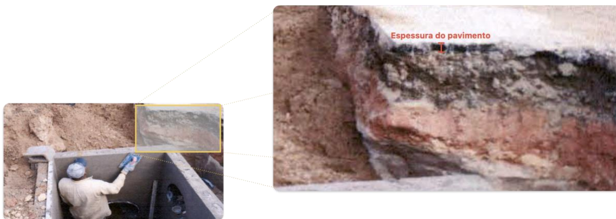
Figura 6: Fotografia com detalhe da espessura do pavimento asfáltico na Av. Concêntrica, onde se atestou e pagou uma espessura de demolição de 20 cm.
